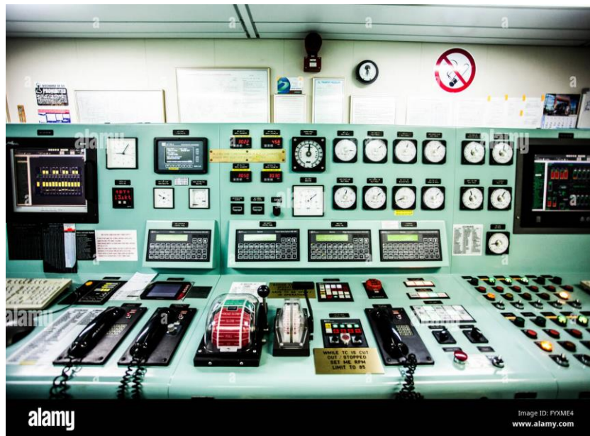
Slika 10: Kontrolna soba strojarnice (engl. engine control room)
