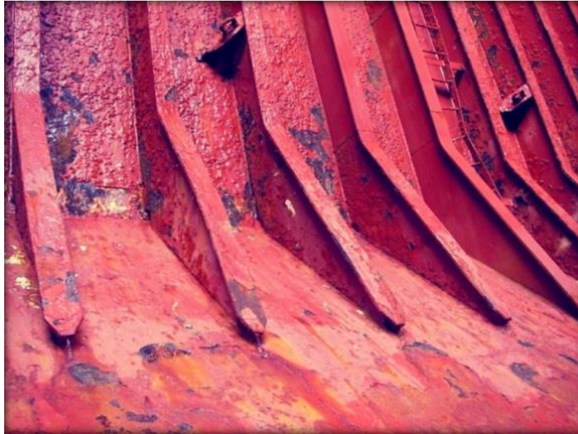
Slika 23: Korozija u skladišnom prostoru
