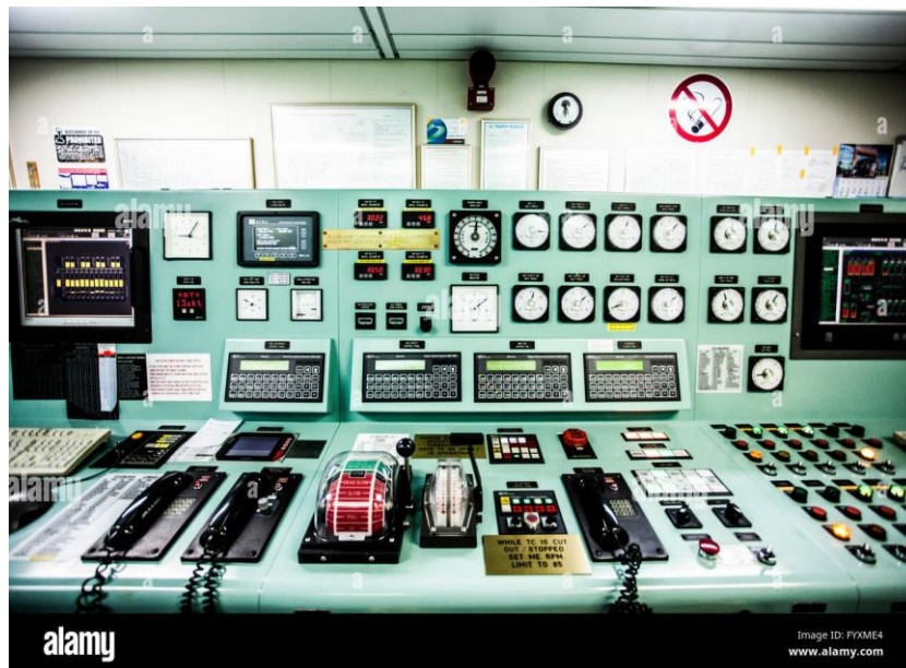
Slika 10: Kontrolna soba strojarnice (engl. engine control room)
