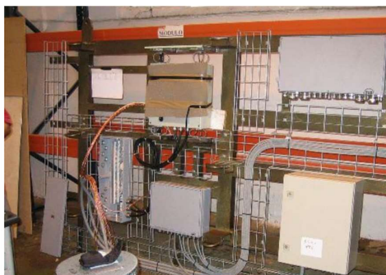
Slika 17. Kabelski nosač na rasklopnoj ploči
