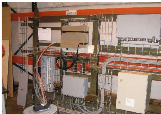
Slika 17. Kabelski nosač na rasklopnoj ploči
