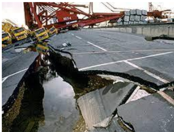
Slika 9 Cesta uništena zbog potresa
