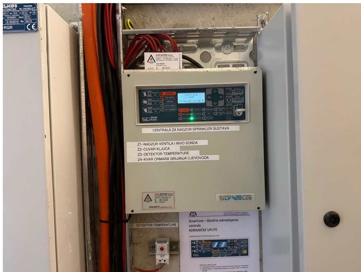
Slika 13 - Centrala za nadzor sprinkler sustava
