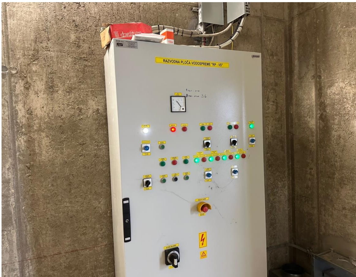
Slika 12 - Razvodna ploča vodospreme za sprinkler sustav
