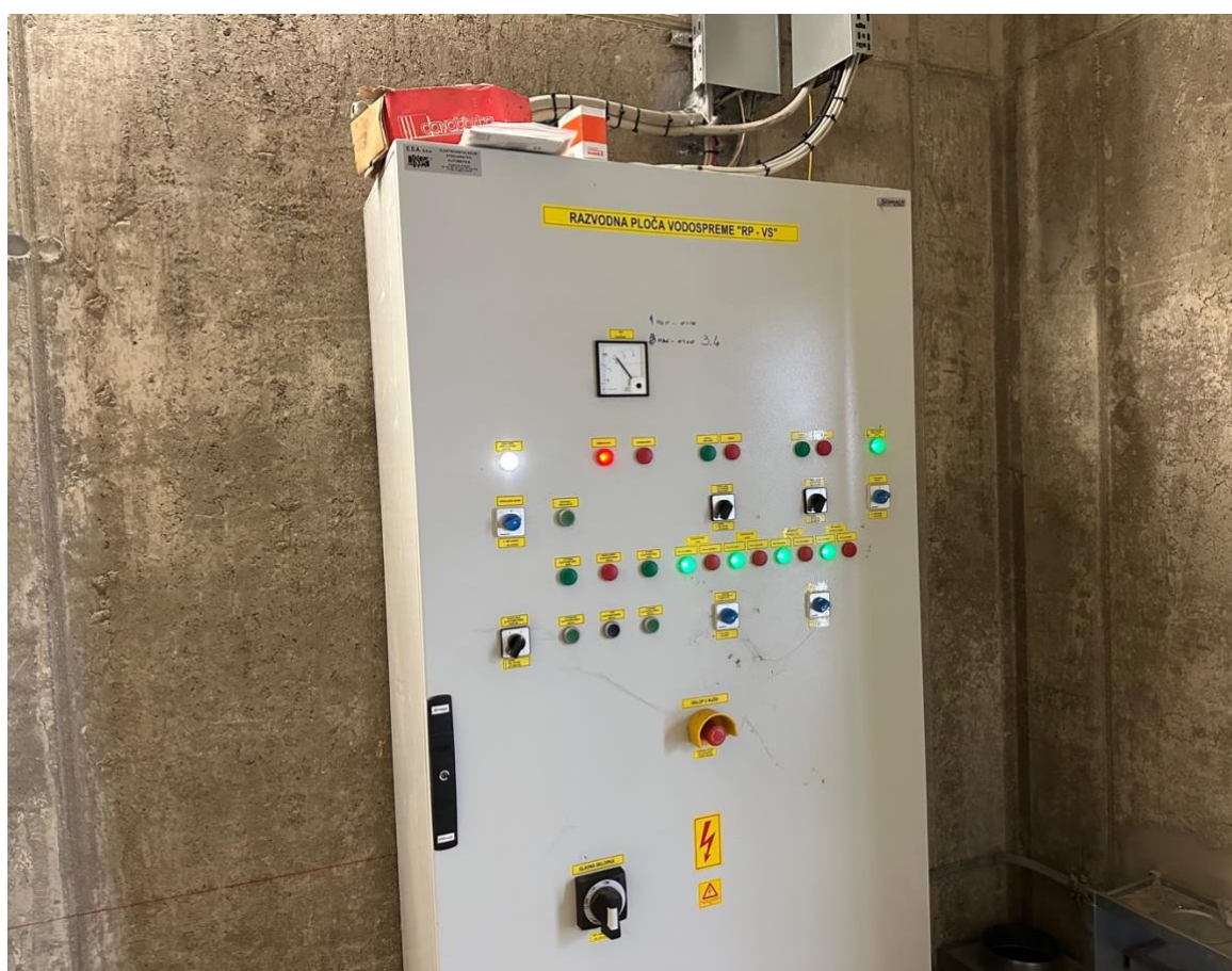
Slika 12 - Razvodna ploča vodospreme za sprinkler sustav
