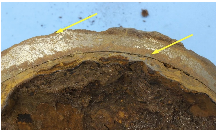
Slika 5. Selektivna korozija cjevovoda
