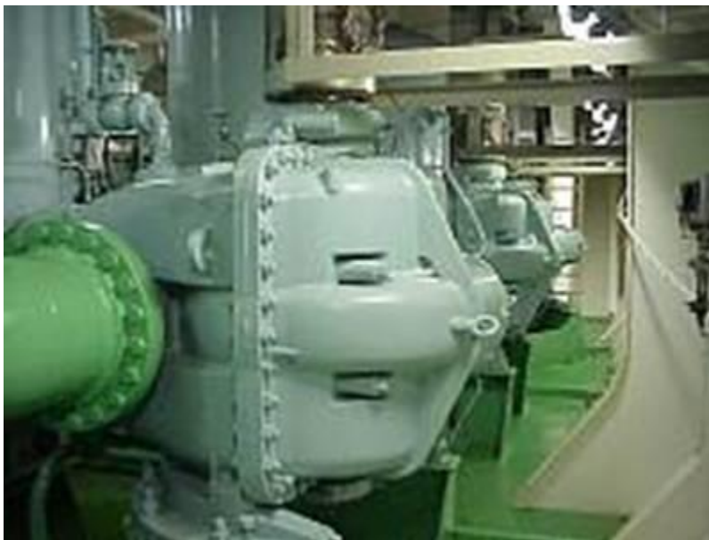
Slika 4. Glavne pumpe tereta
