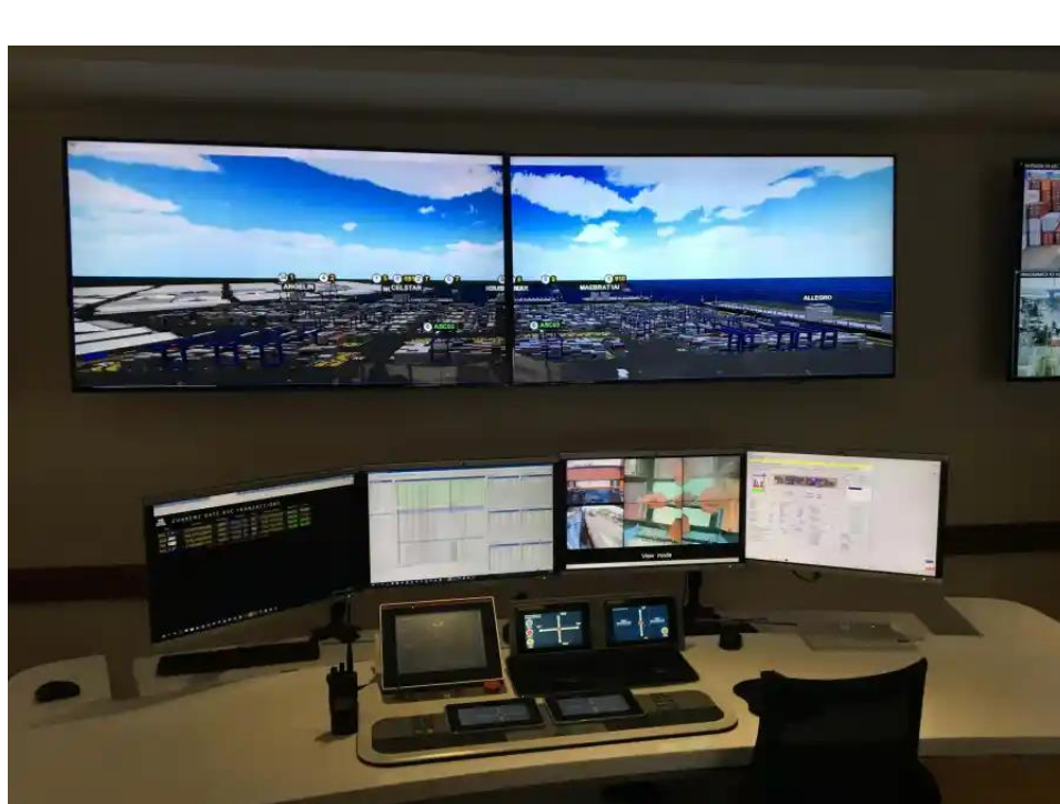
Slika 1. Kontrolna stanica za upravljanje ASC dizalicama
