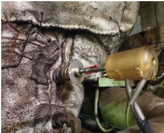
Slika 36. Lokacija mjerenja i priključak sonde
